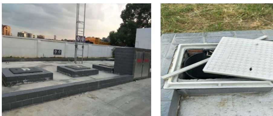
图 3-8 油罐区防渗池及监测井
