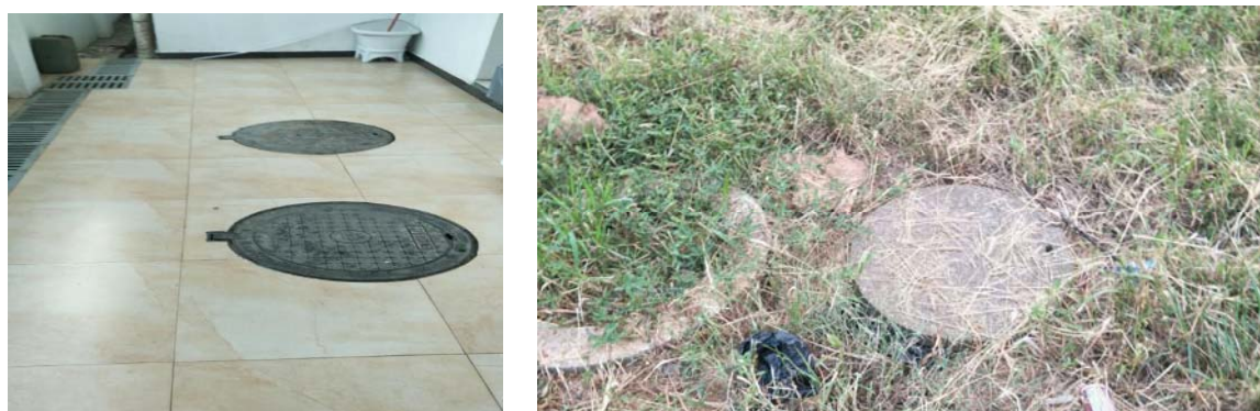
图 3-6 化粪池和隔油池
