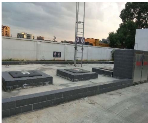
图 6-1 油罐区有组织废气排放立管
