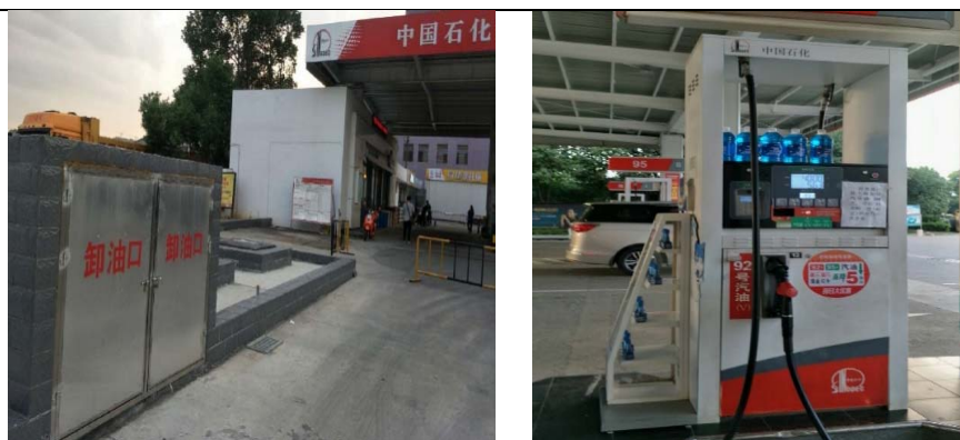
图 3-4 卸油区一次回收系统和加油机二次油气回收系统
