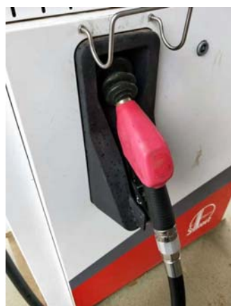
图 3-3 加油机二次油气回收系统
