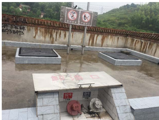
图 3-6 油罐区防渗池及监测井
