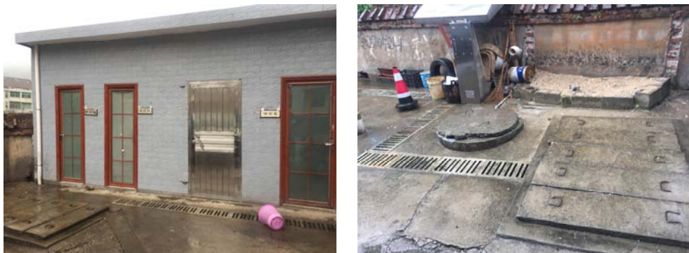
图 3-5 化粪池和隔油池
