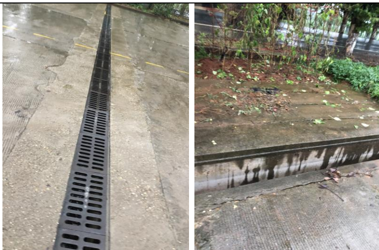
图 3-2 集水沟和隔油池
