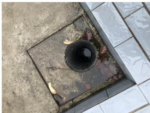
图 3-3 地下水监测井
