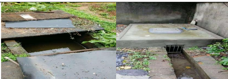
图 3-6 加油站化粪池和隔油池
