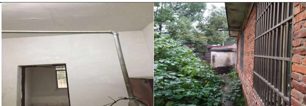
图 3-2 柴油发电机房和尾气排放出口
