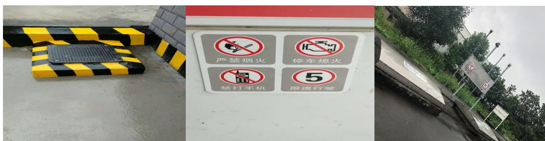
图 3-9 加油站监测井、警告牌和排气立管
