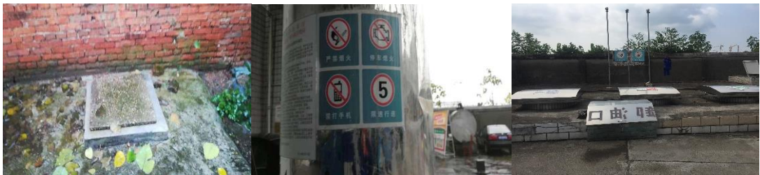
图 3-7 加油站监测井、警告牌和排放立管
