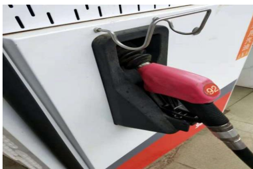
图 3-1 二次油气回收系统
