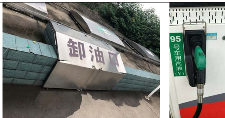
图 3-4 卸油区一次回收系统和加油机二次油气回收系统
