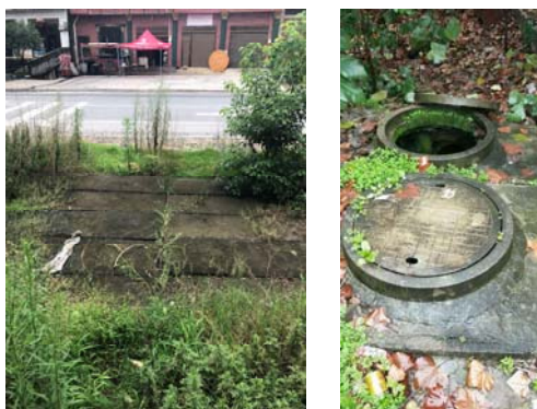
图 3-6 化粪池和隔油池
