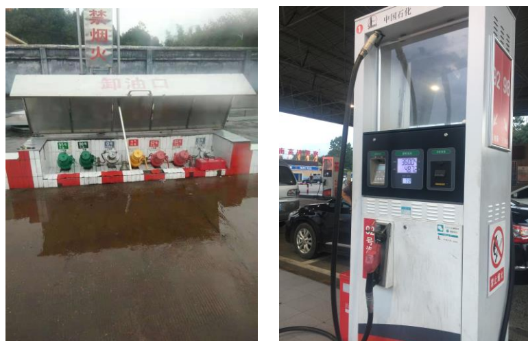
图 3-4 卸油区一次回收系统和加油机二次油气回收系统
