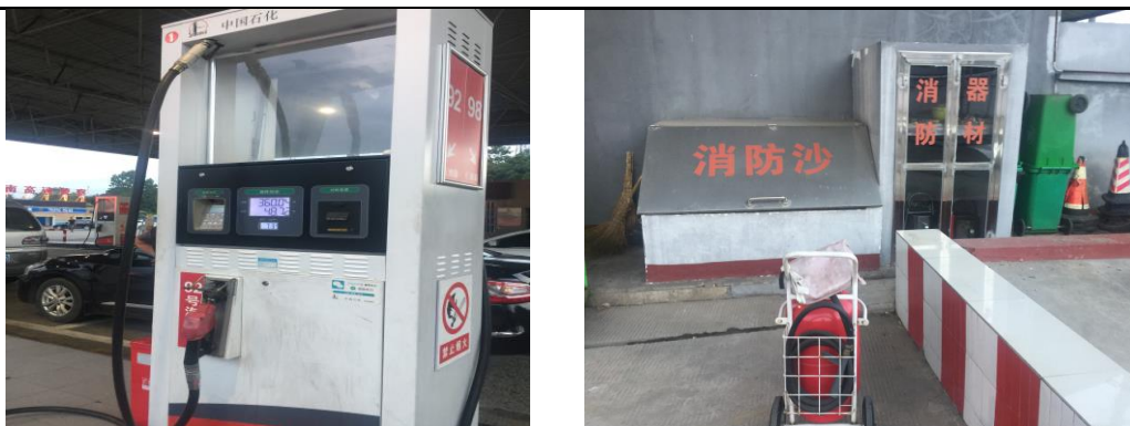
图 3-11 加油站消防设施
