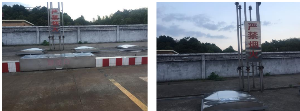
图 3-8 油罐区防渗、监测井
