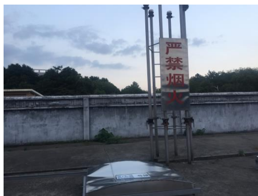
图 6-1 废气有组织排放立管
