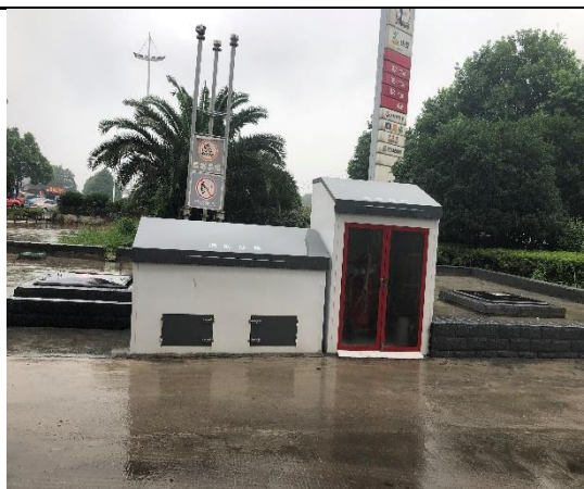
图 3-9 消防沙池、灭火器装置
