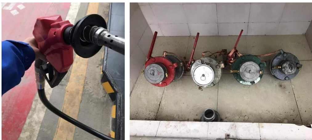
图 3-6 油气回收装置
