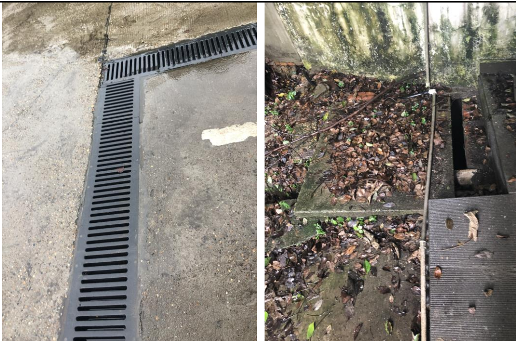
图 3-2 集水沟和隔油池
