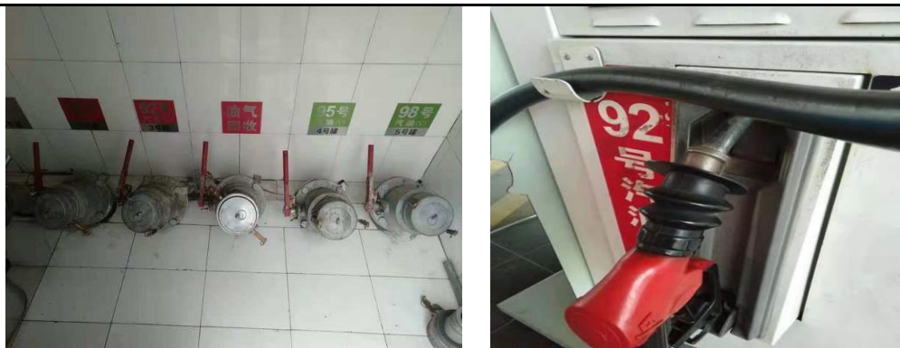
图 3-4 卸油区一次回收系统和加油机二次油气回收系统
