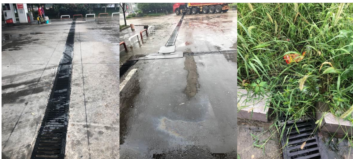
图 3-7 排水、水处理设施照片
