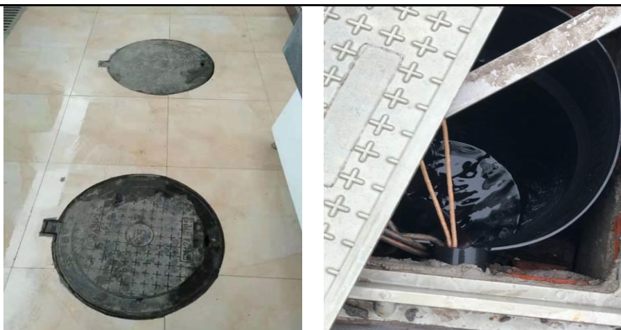
图 3-6 化粪池和隔油池
